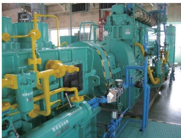
芝浦排水機場
